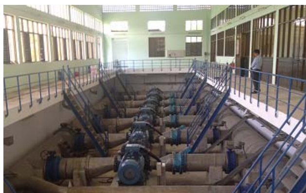
【更新された高効率ポンプ】
